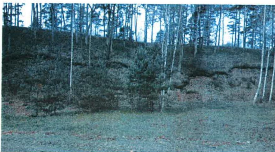
2. Att. Sužu kāpas austrumu nogāzē ierīkots rakums, kas pilnībā stabilizējies. 2015. gada decembris.
