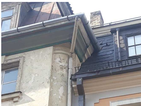
46.attēls. Ēkas Anglikāņu ielā 5 un 3 dzegu, jumtu un sienas savienojuma vieta Foto: SIA "METRUM" 2019.gads
