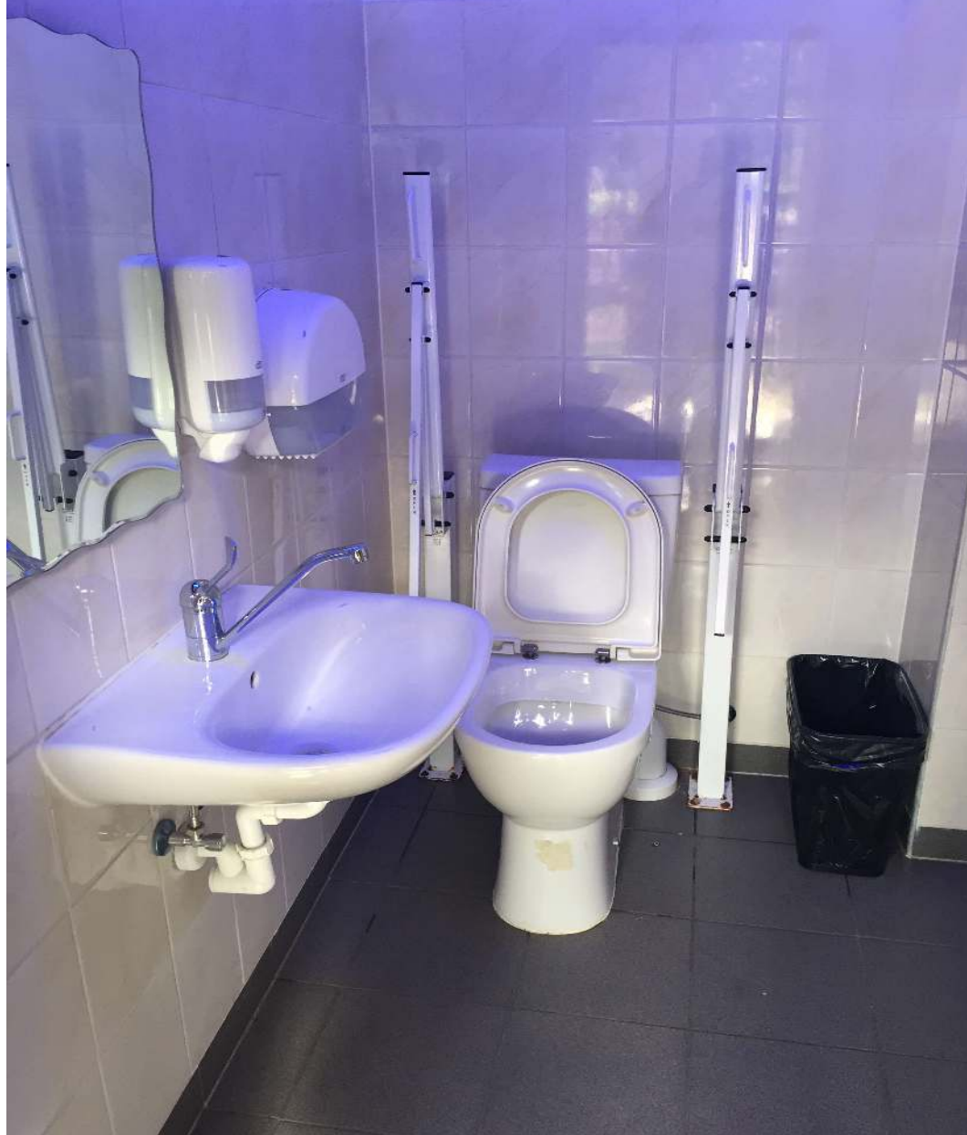
Ziedoņdārza parka atjaunošana Sparģeļu ielā 2: Neatbilstošs aprīkojums invalīdu tualetē ar apgrūtinātu piekļuvi.
