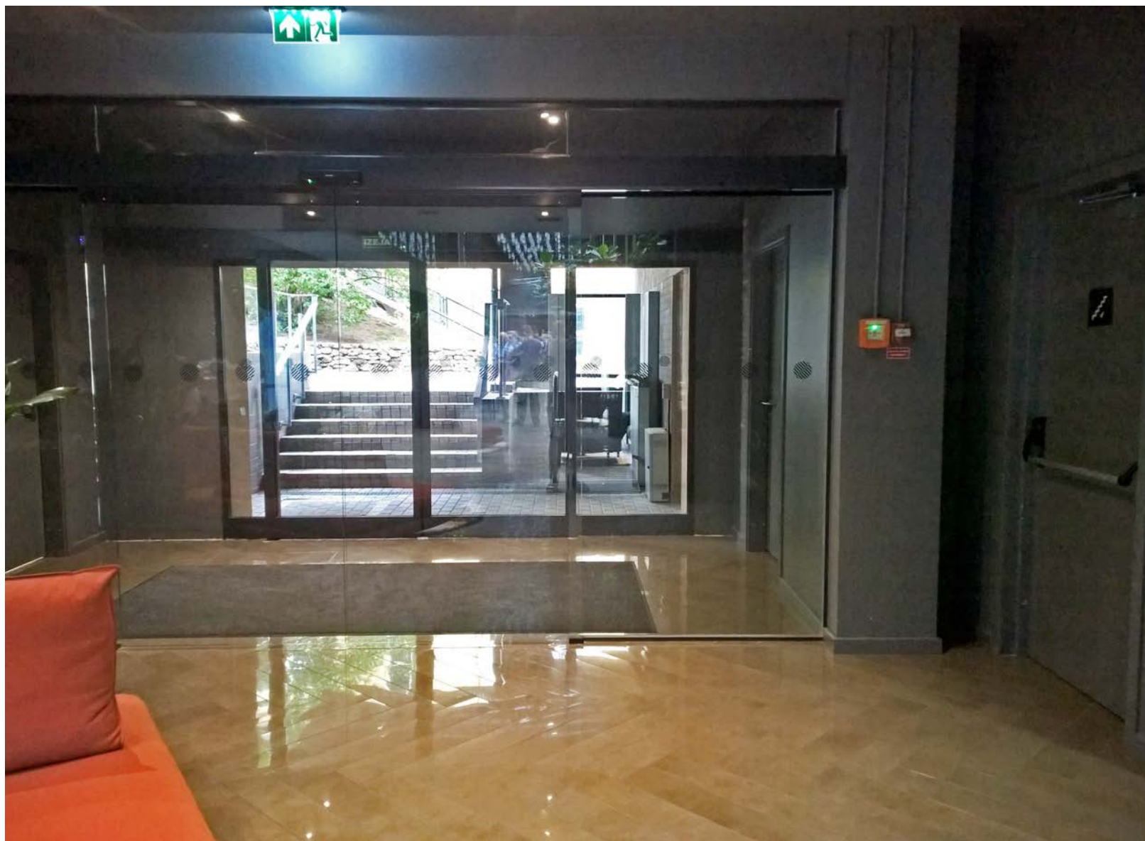
Viesnīca Jēkaba ielā 24: Nepietiekami apzīmētas stiklotās plaknes.
