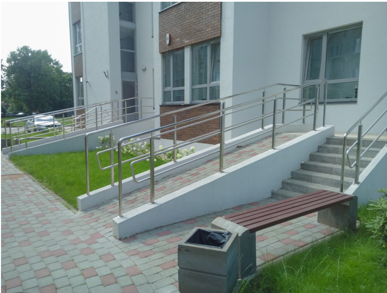
Mazstāvu dzīvojamā māja Ilģuciema ielā 7: Neatbilstošs pandusa slīpums, nav apzīmēts.
