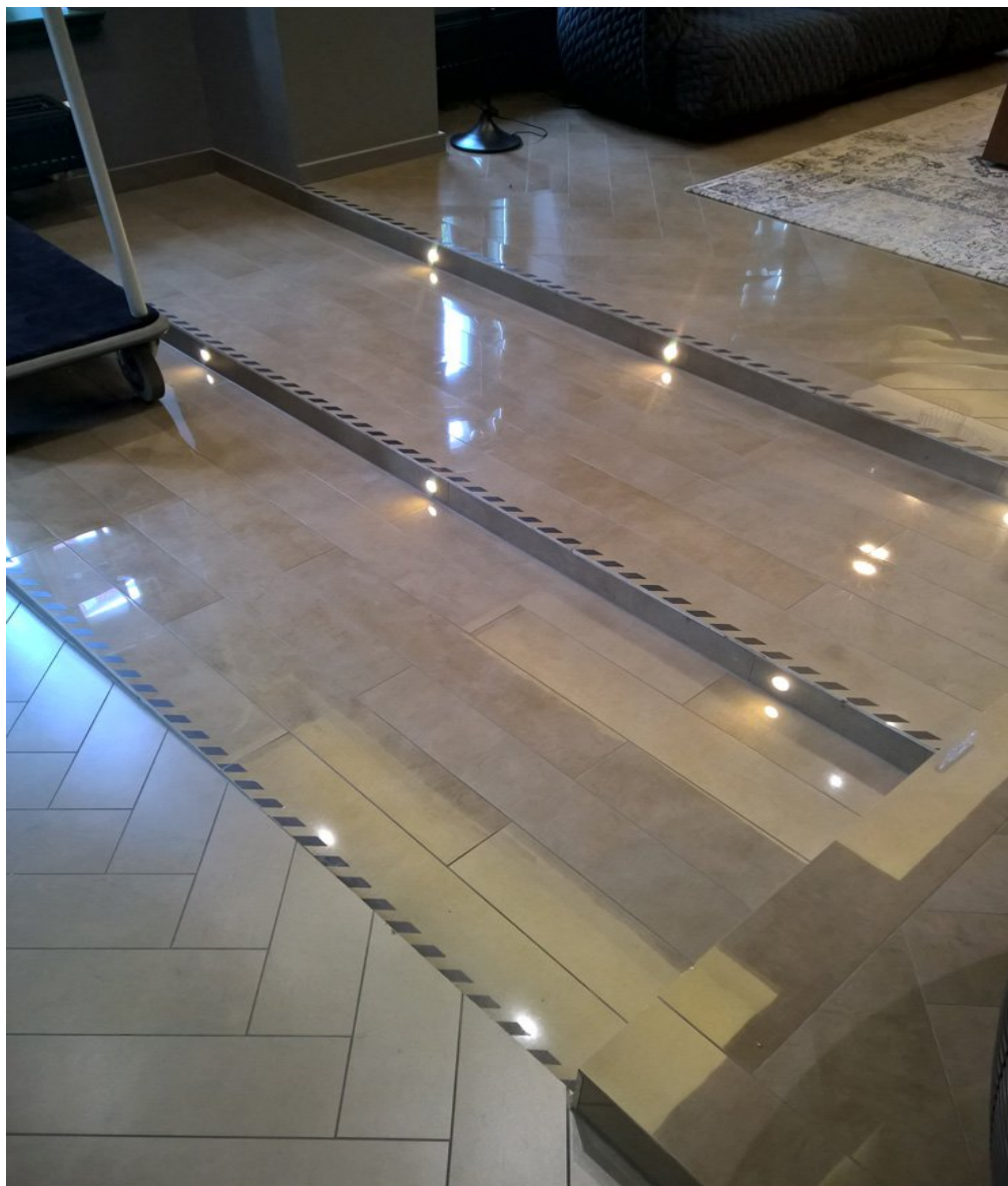
Viesnīca Jēkaba ielā 24: Labi apzīmēti un apgaismoti pakāpieni vestibulā.
