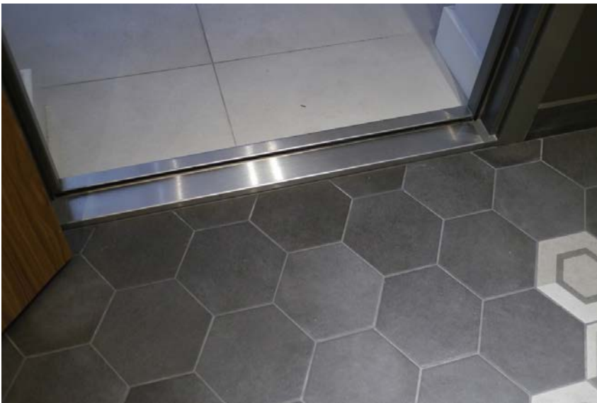
Ugunsdrošo durvju sliekšnis, kura varētu nebūt Dzīvojamo ēku jaunbūve Jāņa Dikmaņa ielā 4
