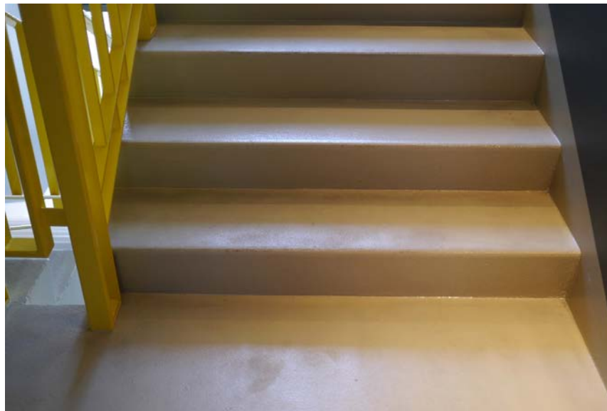
Trūkst pirmā un pēdējā pakāpiena marķējuma Dzīvojamo ēku jaunbūve Jāņa Dikmaņa ielā 4
