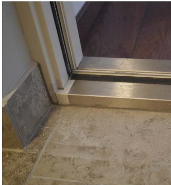
Ugunsdrošo durvju sliekšnis, kura varētu nebūt Dzīvojamo ēku jaunbūve Jūrmalas gatvē 82
