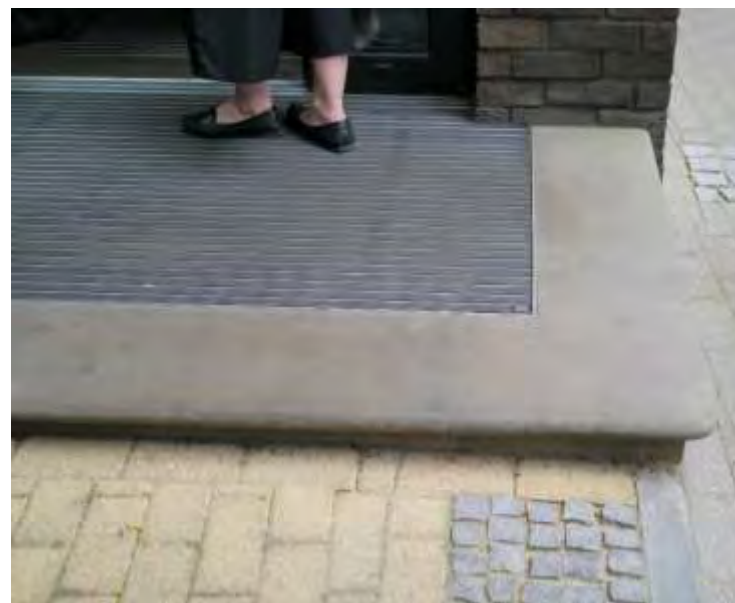
Lai gan ēkā izvietots gabarītizmēros atbilstošs lifts, pakāpiens pirms durvīm liedz to izmantot visiem Dzīvojamā ēka Jeruzalemes ielā 5 un Dzirnavu ielā 36
