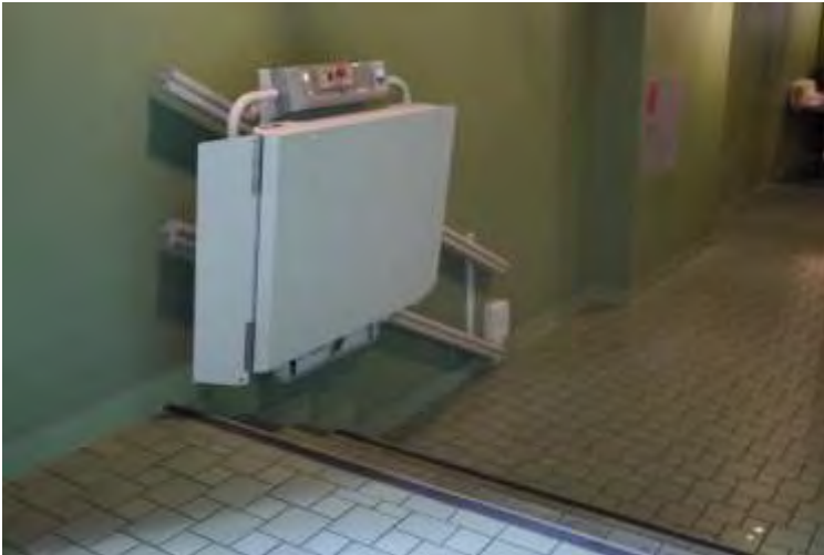
Pacelājs pie kāpnēm uz restorāna zāli, nav pieļaujams risinājums jaunbūvē
